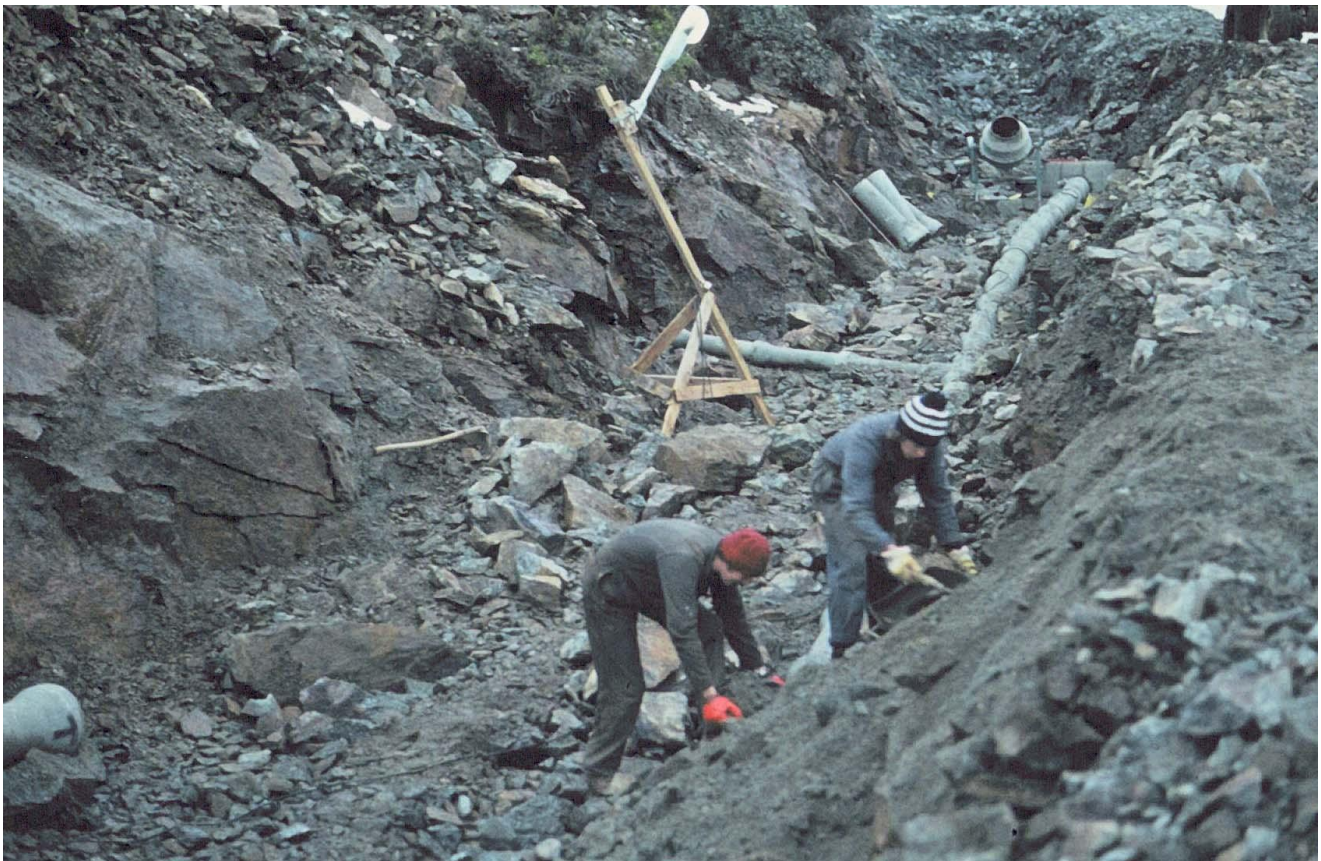
På fylling på rør i veien rett nedenfor krysset i feltet.
